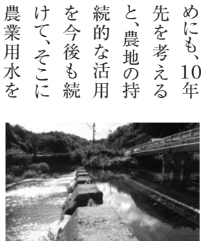
老朽化が進む井堰(東出雲町内の意宇川)
