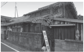
市内の危険な空き家
