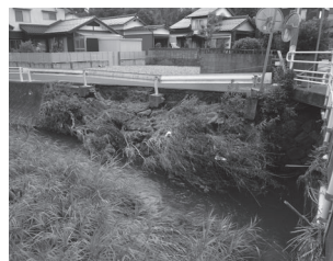
下意東・磯近の護岸崩壊
