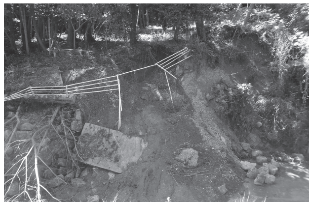
市道西川津西尾線 地すべり災害現場 復旧には1年以上かかる
